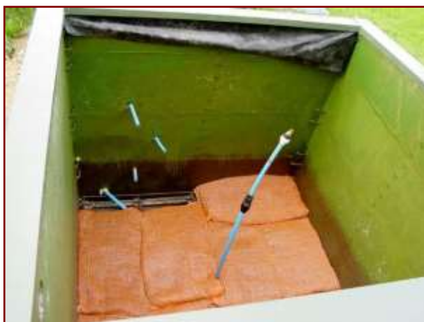
Fot. 8. Wykonanie instalacji hydraulicznej oraz ułożenie na metalowym ruszcie worków z keramzytem
