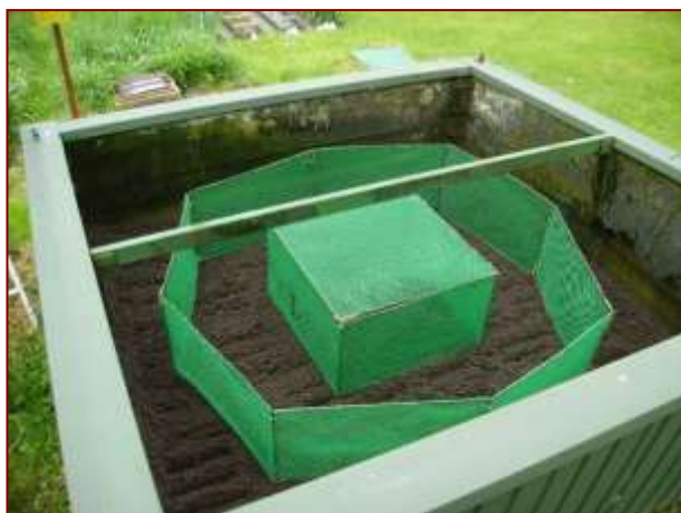
Fot. 11. Siatki wyrównujące rozkład strugi ścieków na złożu
